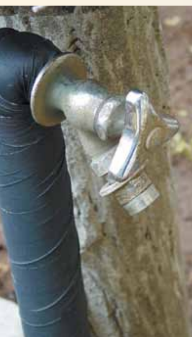
La instalación está también aislada contra las heladas
