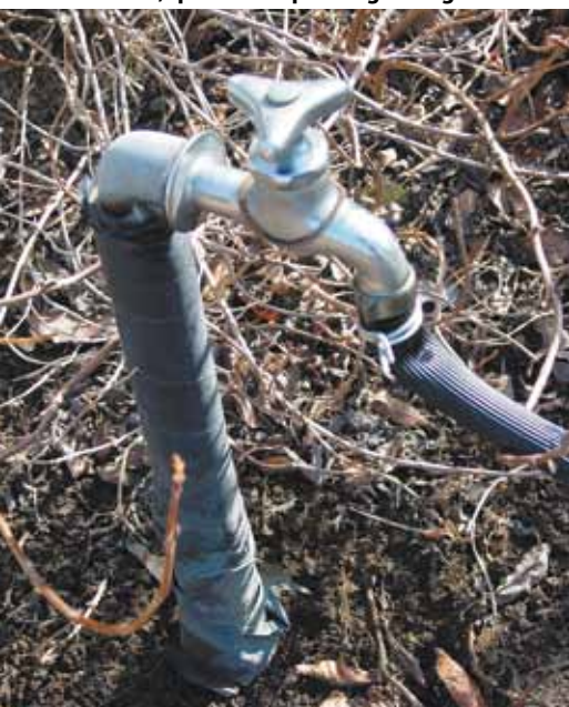
Debido al frío, las conducciones de agua están aisladas de las heladas.
